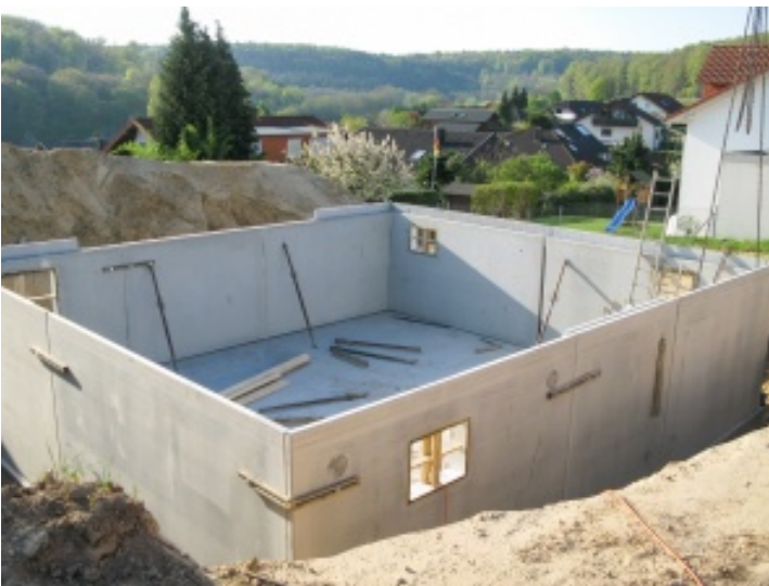
Kellergeschoss aus Beton: das Risiko für Feuchteschäden wird mit gebaut!
