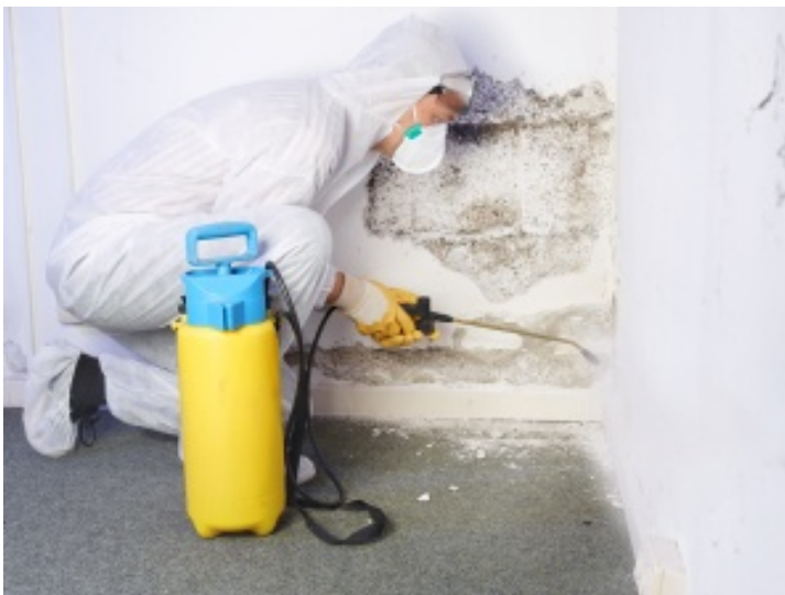
Falsches Lüften ist oftmals Ursache von erheblichen Feuchteschäden!
